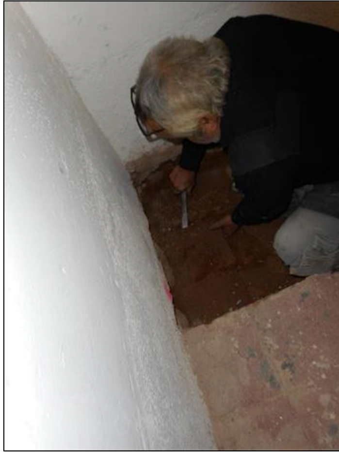
35. Extracció de dues lloses del paviment UE013 per tal d'observar la fonamentació de la masia.
